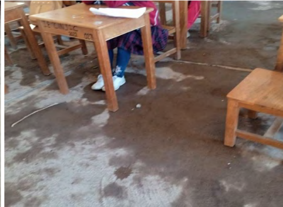
Secundaria Carlos Ismael Noriega -Chupamarca (Castrovirreyna). Filtración de goteras y humedad en el suelo de las aulas.
