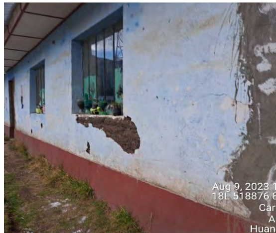
Secundaria Los Libertadores (Angaraes). Vista de la pared exterior del aula con daños por humedad y helada.
