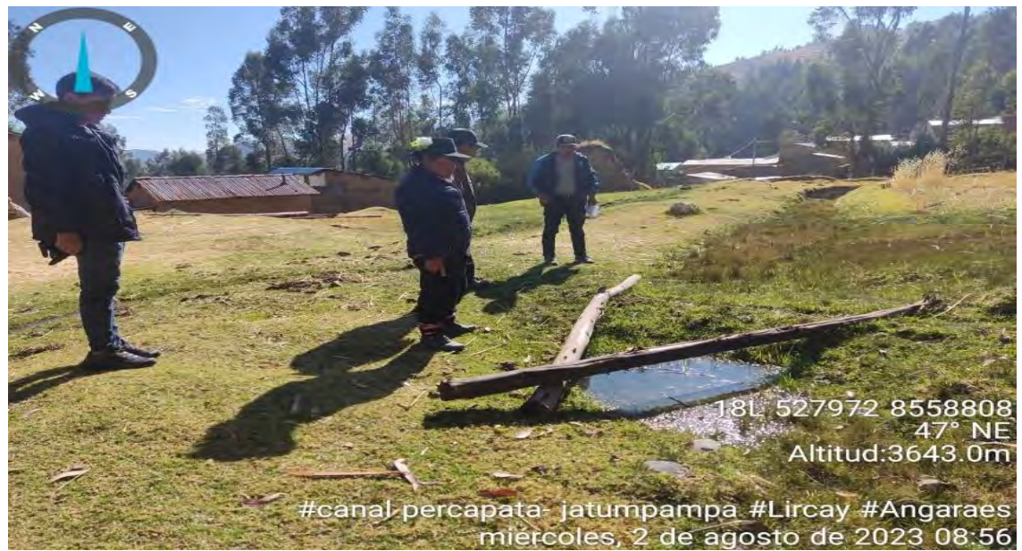
FOTO 03. Se evidencia al personal responsable de diagnóstico situacional en línea de conducción entubado de las coordenadas geográficas este 527972 y oeste 8558808, donde se puede evidenciar filtración de agua por fisura o rajadura de la tubería PVC de 8 pulgadas de una longitud de 180 metros.
