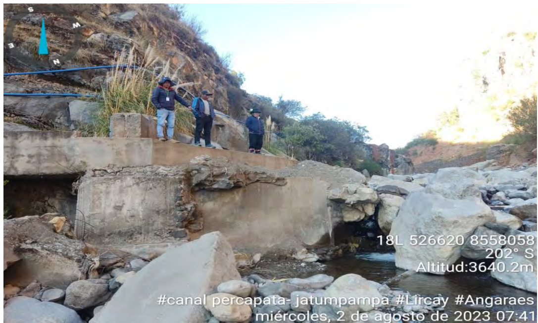
FOTO N° 02. Se evidencia al personal responsable de diagnóstico situacional en captación de las coordenadas geográficas este 526620 y oeste 8558058, donde se puede evidenciar fisura y desborde de la línea de conducción por inundación de huacos una longitud de 50 metros.
