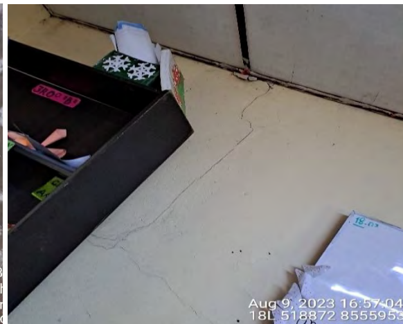
Secundaria Los Libertadores (Angaraes). Fisura en la pared de las aulas de la institución.
