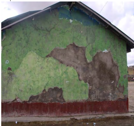
Secundaria José De San Martín Pilpichaca (Huayatará). Parchado de las paredes con grieta por los padres de familia.
