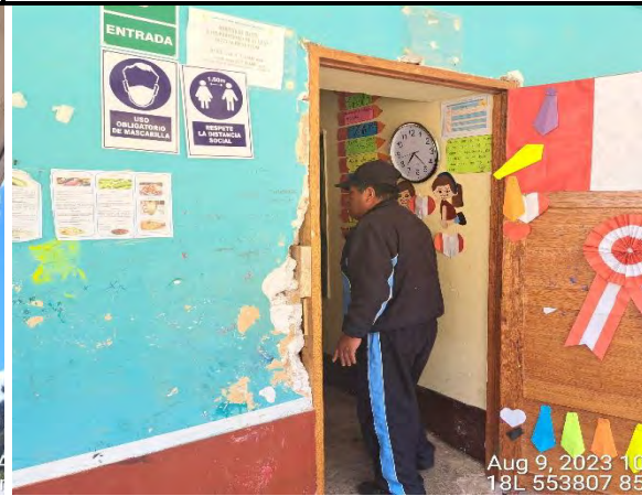
Secundaria Isaac Newton – Secclla (Angaraes). Paredes agrietadas de las aulas de clases.
