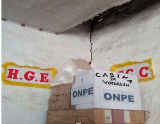
Secundaria Carlos Ismael Noriega -Chupamarca (Castrovirreyna). Vista de las fisuras en las esquinas de las aulas.
