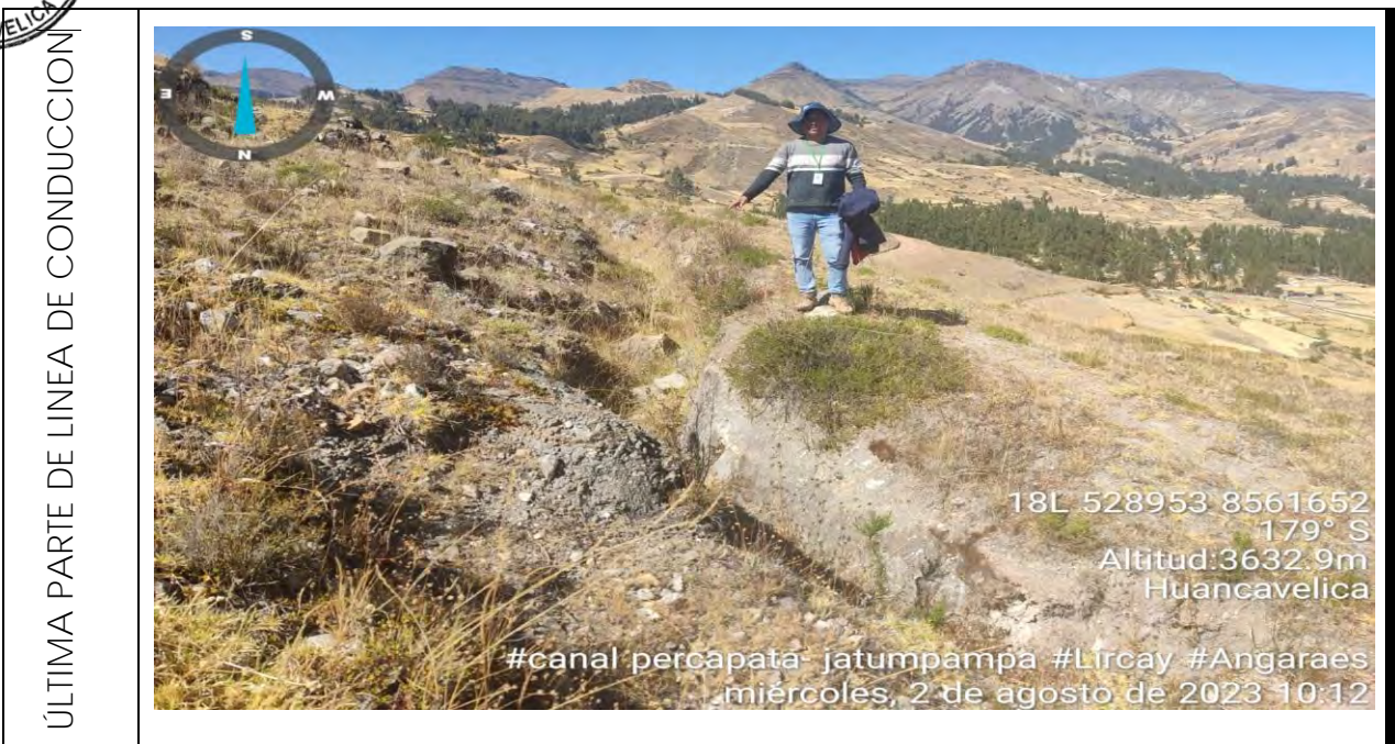
FOTO 08. evidencia al personal responsable de diagnóstico situacional en línea de conducción canal abierto de infraestructura artesanal rustico de las coordenadas geográficas este 528953y oeste 8561652. donde se puede evidenciar rajadura del canal abierto y presencia de malezas y no hay presencia de agua ,según la información de los pobladores mencionan antes llegaba el agua pero ahora no llega por presencia de filtración en zonas críticas de una longitud de 200 metros de línea de conducción rustico.
