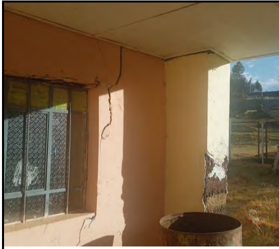
Secundaria Rigoberto Calle Escobar Huando (Huancavelica). Paredes agrietadas que están a punto de colapsar.
