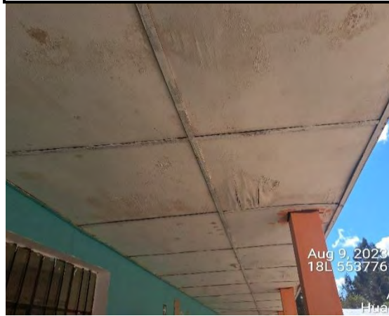
Secundaria Isaac Newton – Secclla (Angaraes). Techo dañado por humedad en los pasadizo de la institución.
