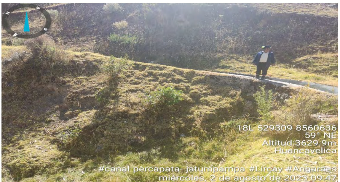
FOTO 06. Se evidencia al personal responsable de diagnóstico situacional en línea de conducción de canal abierto de infraestructura concreto de las coordenadas geográficas este 529309 y oeste 8560636, donde se puede evidenciar filtración de agua por fisura o rajadura del canal abierto de una longitud de 40 metros.
