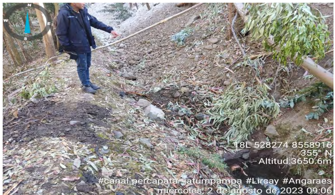
FOTO 04. Se evidencia al personal responsable de diagnóstico situacional en línea de conducción entubado de las coordenadas geográficas este 528274 y oeste 8558916, donde se puede evidenciar filtración y empozamiento de agua por presencia de malezas y formación de raíces en la línea de conducción de la tubería PVC de 8 pulgadas de una longitud de 50 metros.
