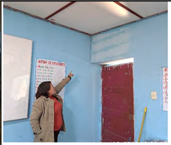
Secundaria Ciro Alegria Bazan – Anco (Churcampa). Fisuras en las diferentes aulas de la institución.
